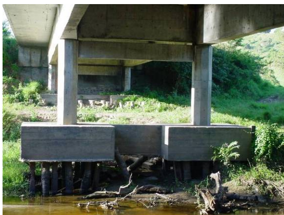
Figura 7 - Estacas expostas e desconfinadas por causa do rebaixamento do leito do rio.
