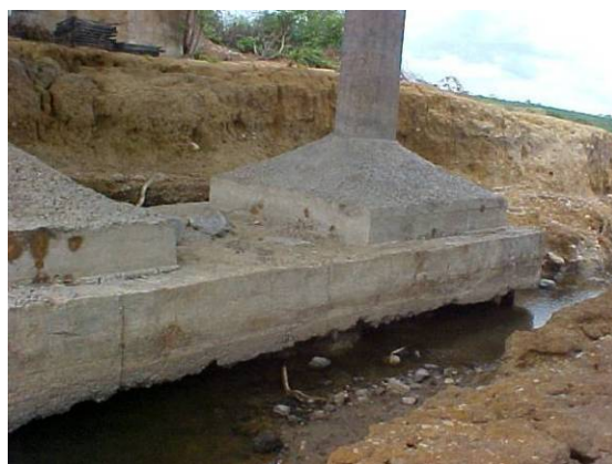
Figura 2 - Fuga de material sob as fundações, causando risco de colapso da ponte.
