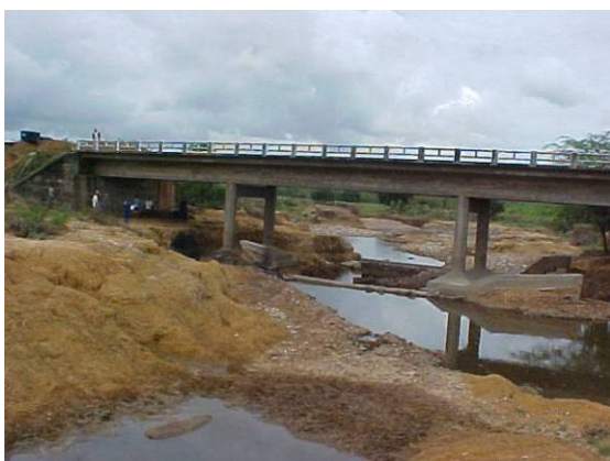
Figura 1 - Vista geral da ponte e da erosão causada pela cheia nas fundações dos pilares na calha do riacho Ingazeiro.
