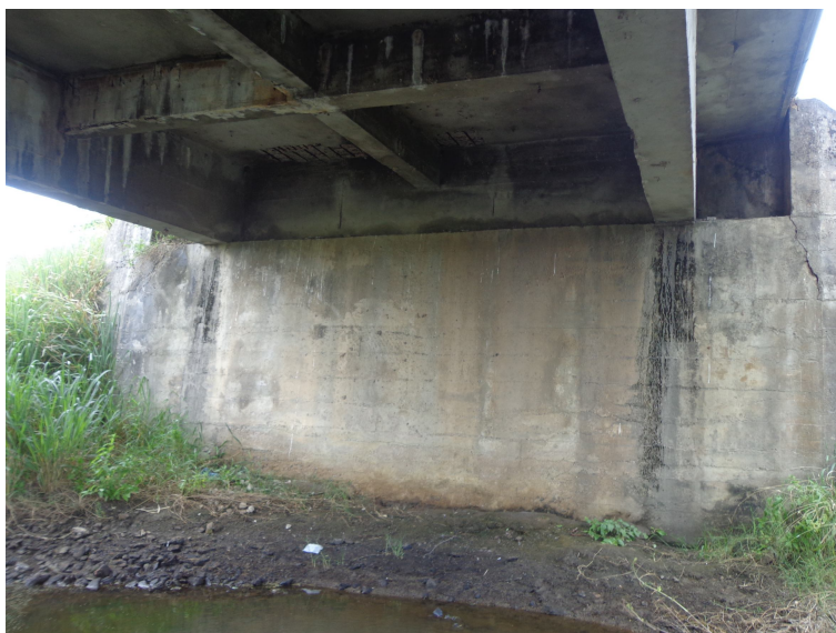
Figura 69 - Vista frontal dos encontros de concreto ciclópico e do avançado estado de deterioração estrutural do tabuleiro (Ponte sobre o rio Patu - BR-230/PB).
