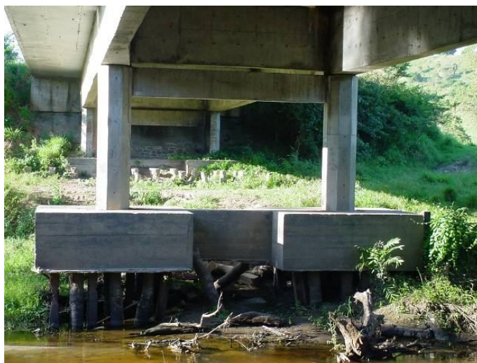
Figura 25 - Estacas expostas e desconfiadas por causa do rebaixamento do leito do rio. (Ponte na BR 101/BA).
