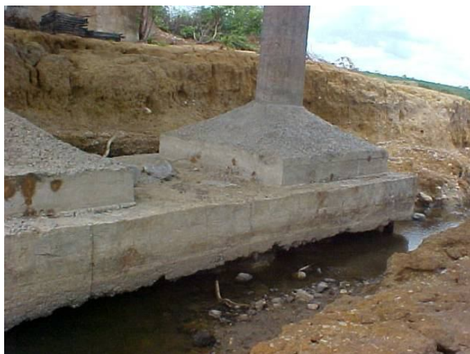
Figura 18 - Fuga de material sob as fundações, causando risco de ruptura da obra. (Ponte sobre o Riacho Ingazeiro – PE-057).
