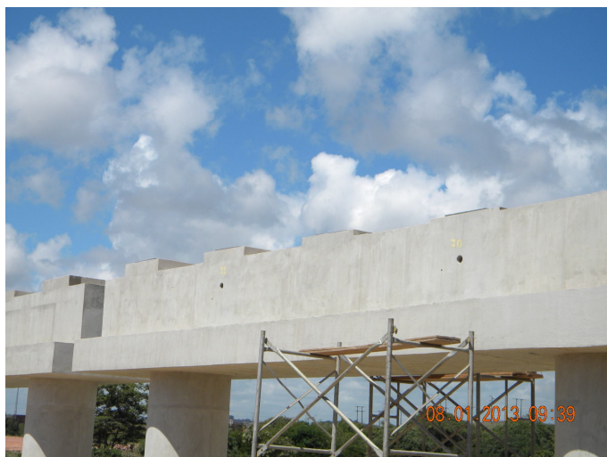
Figura 37 - Algumas travessas também apresentaram não conformidade do concreto. (Ponte sobre o rio Pirapama - Suape).
