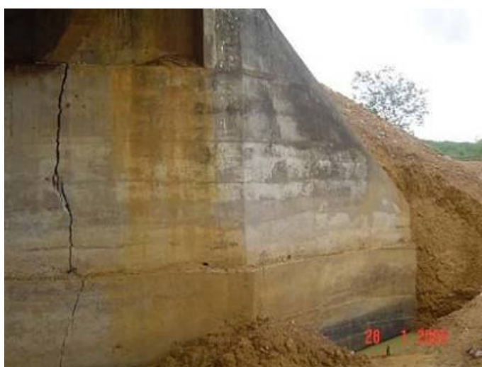
Figura 19 - Ruptura do encontro causada por infiltração de água no aterro e pela erosão na fundação. (Ponte sobre o Riacho Ingazeiro - PE-057).
