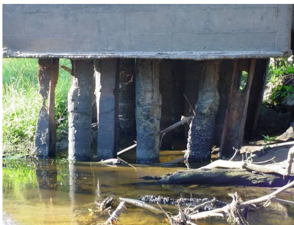
Figura 26 - Detalhe da deterioração e perda de seção transversal das estacas. (Ponte na BR 101/BA).
