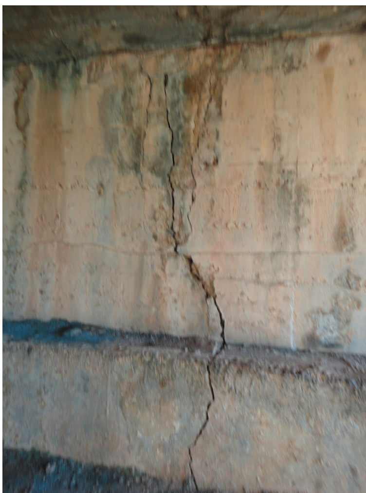
Figura 58 - Grande fissura na parede frontal do encontro (Ponte na RJ-158).
