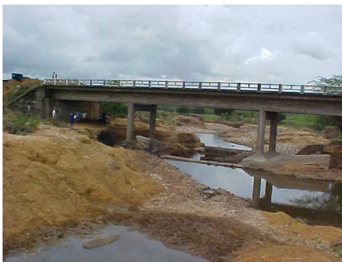
Figura 16 - Vista geral da ponte e da erosão causada pela cheia nas fundações dos pilares na calha do rio. (Ponte sobre o Riacho Ingazeiro - PE-057)
