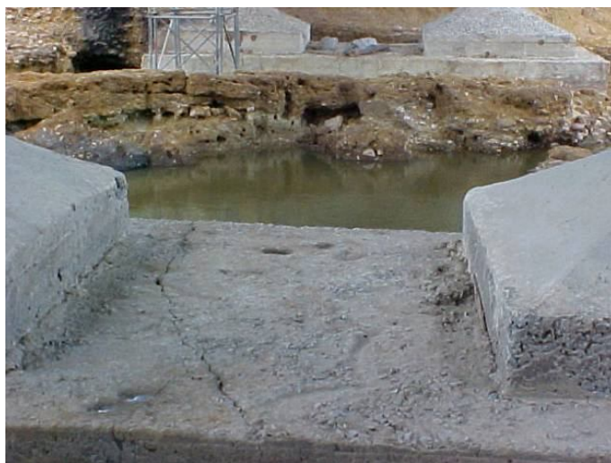
Figura 17 - Ruptura do bloco e descalçamento das fundações. (Ponte sobre o Riacho Ingazeiro – PE-057).
