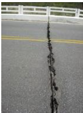
Figura 6. Degradação e abertura excessiva da junta de dilatação.
