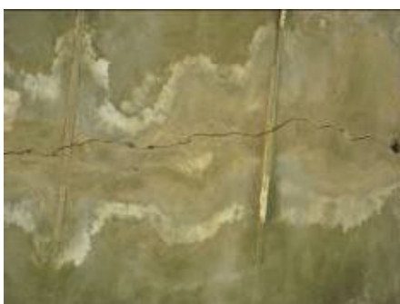
Figura 12. Fissura transversal na face inferior do caixão celular, além de manchas de umidade e eflorações causadas pelas constantes infiltrações no tabuleiro.
