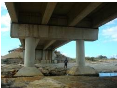
Figura 9. Infiltrações generalizadas nos encontros e no tabuleiro, além de erosão no leito do rio.
