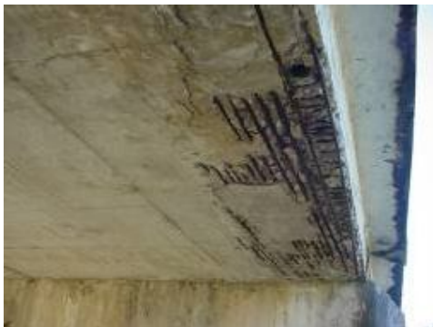
Figura 5. Destruição do concreto, com exposição e oxidação das armaduras do tabuleiro em laje.
