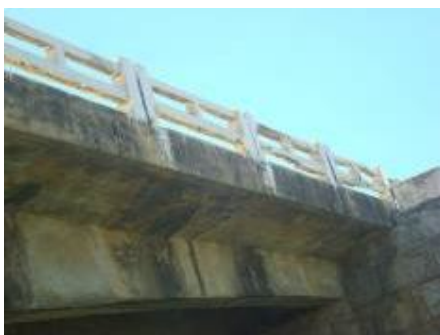
Figura 13. Manchas no concreto provocadas por infiltrações e umidade no tabuleiro, situação representativa de 69 pontes analisadas.
