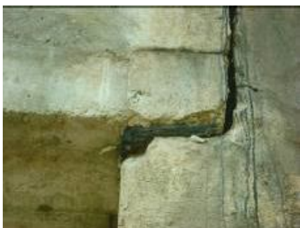
Figura 7. Avançado estado de deterioração dos aparelhos de apoio.
