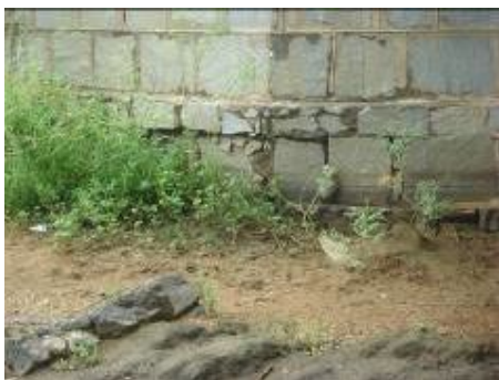
Figura 10. Deformações, desagregação e erosão em encontro de alvenaria de pedras.
