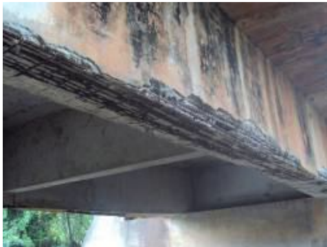
Figura 4. Grande deterioração estrutural do tabuleiro, com exposição e oxidação das armaduras das vigas.
