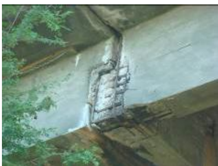
Figura 11. Dente Gerber com exposição de armaduras e avançado estado de degradação do concreto, com implicações de risco estrutural.
