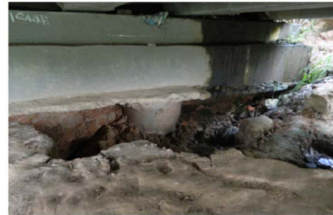
Figura 12. Presença de grande erosão na fundação.
