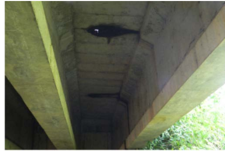
Figura 10. Dreno danificado provocando infiltração e manchas de umidade na laje entre longarinas
