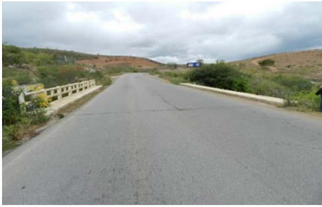
Figura 9. Ausência de guarda-corpo na lateral da ponte
