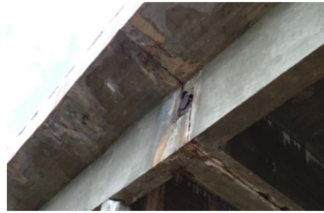
Figura 7. Aparelho de apoio metálico em um dente Gerber com visíveis danos e infiltrações.
