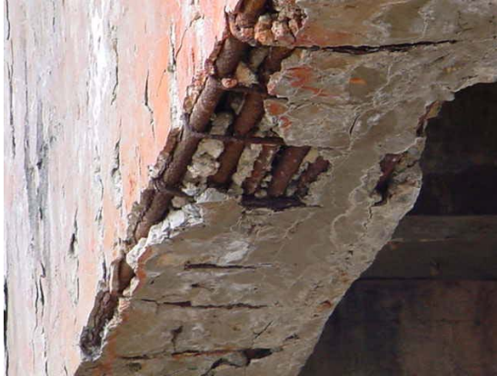
Foto 2 – (OAE N° 36) – Ponte sobre o rio Jacareí - BR-343/PI - Detalhe do avançado grau de deterioração do concreto e oxidação das armaduras das vigas principais.
