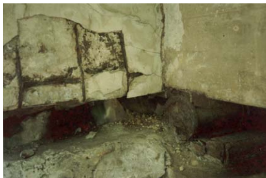
Foto 7 – (OAE N° 05) – Ponte sobre o rio Botafogo - BR-101/PE - Estado de pré-ruína na ligação meso/superestrutura, evidenciando-se a destruição do concreto e armaduras além do travamento dos aparelhos de apoio.
