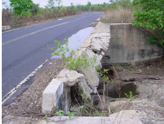
Foto 11 – (OAE N° 38) – Ponte sobre o rio Raposo - BR-343/PI - Vista superior mostrando a destruição dos guarda-corpos, empocamento de água sobre o tabuleiro e desnível na pista causado pela diferença entre a parte central do tabuleiro (original) e as partes laterais (alargamento), tudo isto significando grandes riscos de ocorrência de acidentes.
