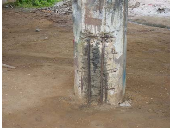
Foto 8 – (OAE N° 12) – Ponte sobre o rio Preto – BR-101/BA – Pilar com deslocamento do concreto, oxidação das armaduras e destruição dos estribos na parte inferior, caracterizando uma situação bastante crítica.
