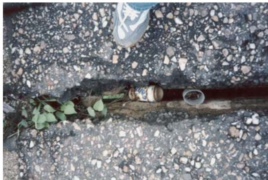
Foto 9 – (OAE N° 39) – Ponte sobre o rio Traíras - BR-428/PE - Abertura excessiva da junta de dilatação do tabuleiro, causando infiltração e desconforto ao tráfego. Observar a destruição do pavimento.
