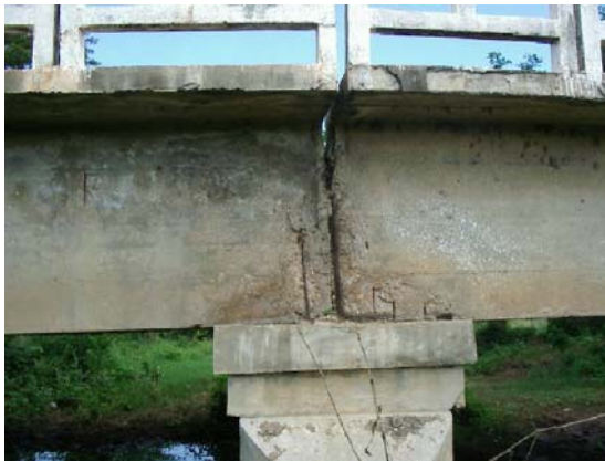
Foto 3 – (OAE N° 31) – Ponte sobre o rio Tamanduá - BR-116/CE - Abertura excessiva da junta do tabuleiro, esmagamento do concreto nos apoios e patologias diversas nas vigas principais.
