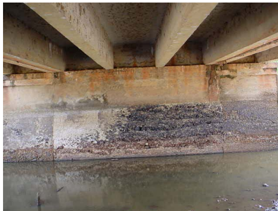
Foto 6 – (OAE N° 37) – Ponte sobre o rio Titara - BR-343/PI - Detalhe do apoio central da obra, mostrando o alargamento realizado anteriormente. Observam-se fissuras verticais dos dois lados, nas partes onde a ponte foi alargada, e a grande intensidade de lixiviação do concreto do pilar. O tabuleiro apresenta trechos com exposição e corrosão das armaduras, além de infiltração e eflorescências.
