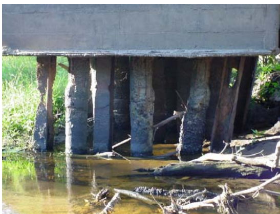
Foto 4 – (OAE N° 10) – Ponte sobre o rio Pojuca - BR-101/BA - Situação atual das estacas de fundação da ponte, caracterizando a falta de confinamento lateral, além de oxidação das estacas metálicas e avançado grau de degradação das estacas de concreto. A grande perda da capacidade de carga das estacas pode causar a ruptura iminente da obra.
