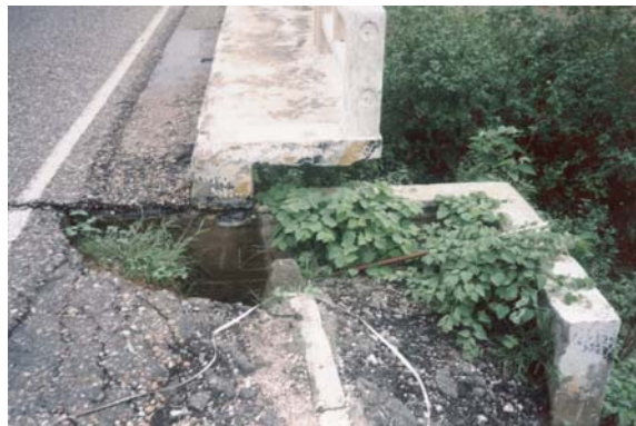
Foto 12 – (OAE N° 40) – Ponte sobre o rio Brigida - BR-428/PE - Erosão no aterro de acesso na ligação ponte/rodovia, cuja evolução poderá desestabilizar o encontro. A situação é agravada pela ausência de laje de transição.
