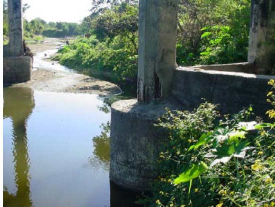
Foto 5 – (OAE N° 22) – Ponte sobre o rio Paratigi - BR-116/BA - Desplacamento do concreto com exposição e corrosão das armaduras longitudinais e destruição dos estribos nos pilares, na ligação com o fuste dos tubulões, reduzindo consideravelmente a resistência dos pilares na seção mais crítica.
