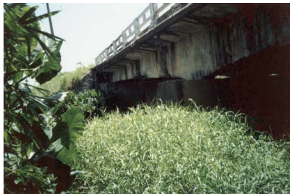
Foto 10 – (OAE N° 07) – Ponte sobre o rio Igarassu - BR-101/PE - O avançado estado das patologias nas super, meso e infra-estrutura já devem estar comprometendo a estabilidade da obra, principalmente pela corrosão e grandes perdas de seção transversal e de aderência das armaduras.
