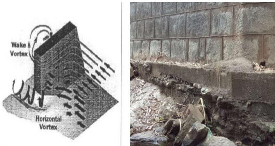
Figura 1.15 - a) Vórtices da correnteza em torno dos encontros. (Fonte: CARDOSO,2008) b) Cavidade de erosão na fundação de um encontro. (Fonte: acervo do autor)
