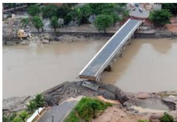
Figura 4.13 - Vista aérea da ponte após a destruição dos aterros de acesso pela cheia. (Fonte: G1, 2010)
