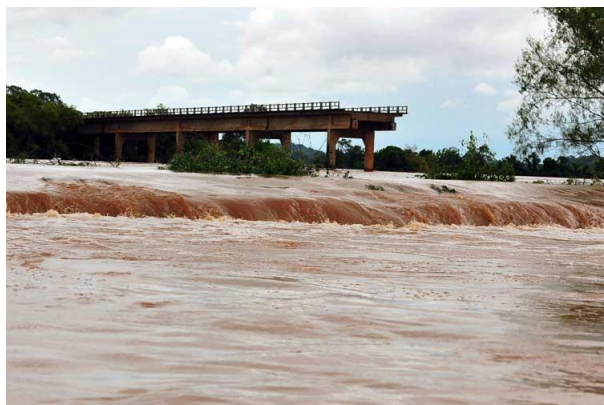
Figura 3.11 - A parte que restou da estrutura da ponte sobre o rio Jacuí após o colapso. (Fonte: Internet, 2010)
