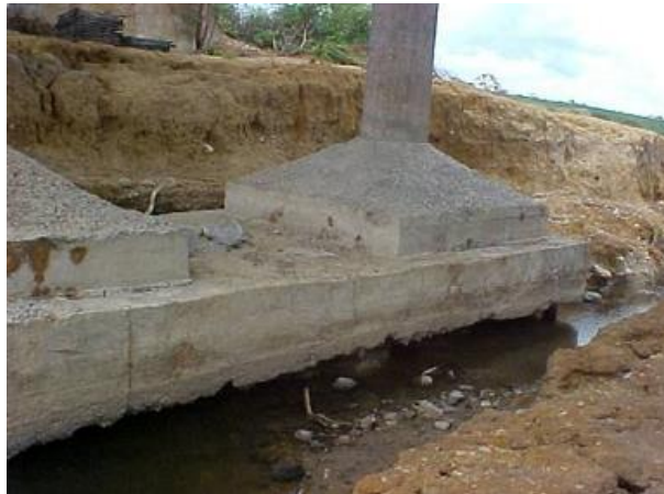
Figura 3.2 - Fuga de material sob as sapatas causando risco de colapso da ponte. (Fonte: acervo do autor)
