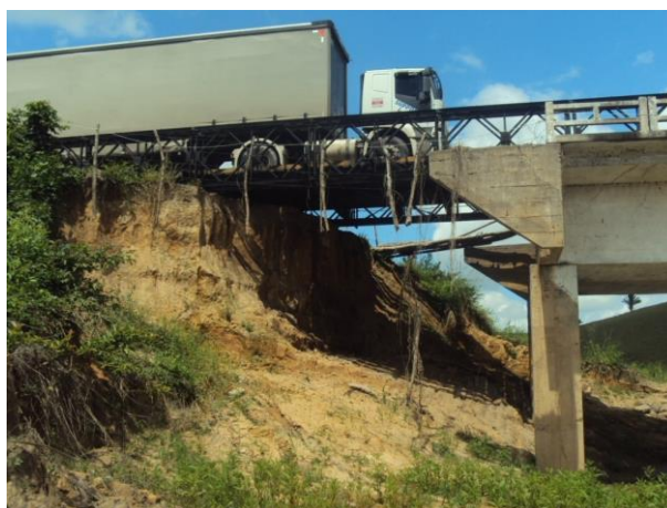
Figura 4.9 - Destruição de aterro de acesso de ponte sem encontros e com o restabelecimento temporário do tráfego através de ponte provisória. (Fonte: acervo do autor)
