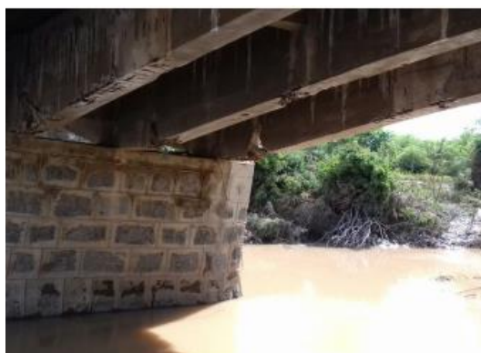
Figura 3.18 - Deslocamento transversal do pilar parede e os danos no tabuleiro. (Fonte: acervo do autor)
