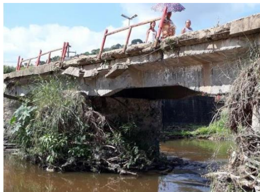
Figura 2.7 - Retenção de detritos com grande obstrução da seção de vazão sob a ponte. (Fonte: BURGOS e VITÓRIO, 2017)
