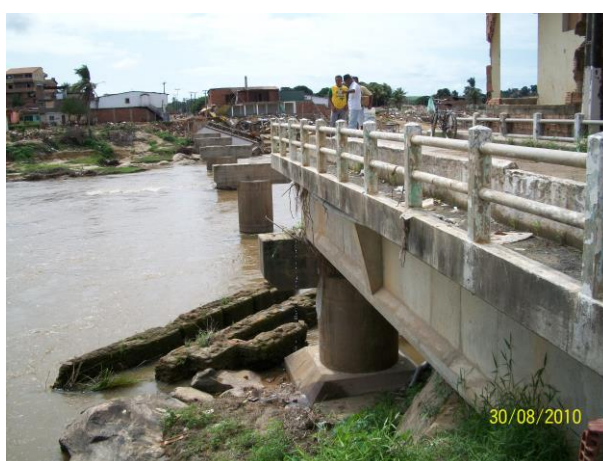
Figura 2.2 - Aspecto da ponte após o colapso, com a maior parte do tabuleiro de vigas simplesmente apoiadas arrancado pela cheia. (Fonte: acervo do autor)
