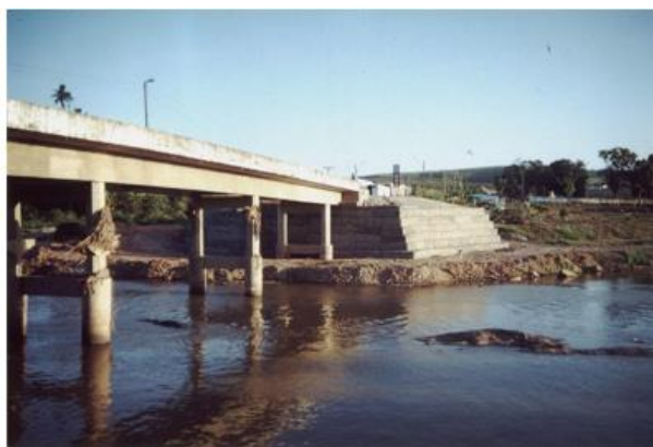
Figura 4.15 - Reconstrução de aterro de acesso com proteção em gabões. (Fonte: acervo do autor)
