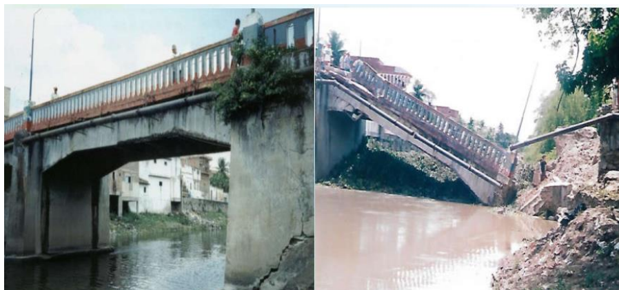
Figura 3.14 - colapso de uma ponte antiga que já apresentava sinais de de ruptura por cisalhamento em um dos encontros. (Fonte: acervo do autor)
