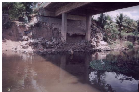
Figura 4.10 - Destrução do talude devido a alterações no leito do rio. (Fonte: acervo do autor)
