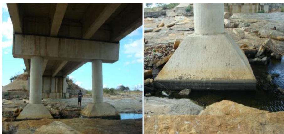
Figura 3.5 - Erosão localizada em torno de fundações diretas executadas sobre rocha fraturada sem maiores estudos. (Fonte: acervo do autor)
