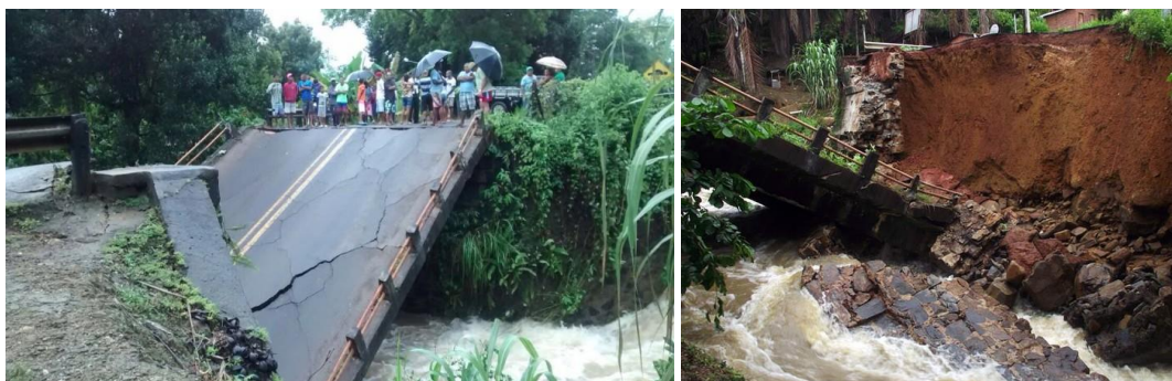
Figura 3.15 - Aspecto da ponte após o desabamento. (Fonte: PREFEITURA DE ITUBERÁ, 2014).
