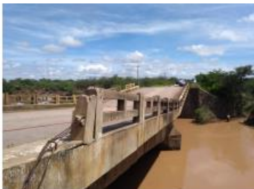
Figura 3.16 - Vista superior da ponte com o tabuleiro deslocado após a cheia. (Fonte: acervo do autor)
