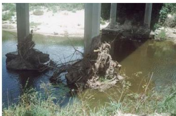
Figura 3.4 - Retenção de detritos em torno dos pilares e erosão localizada, com início de solapamento das fundações. (Fonte: acervo do autor)
