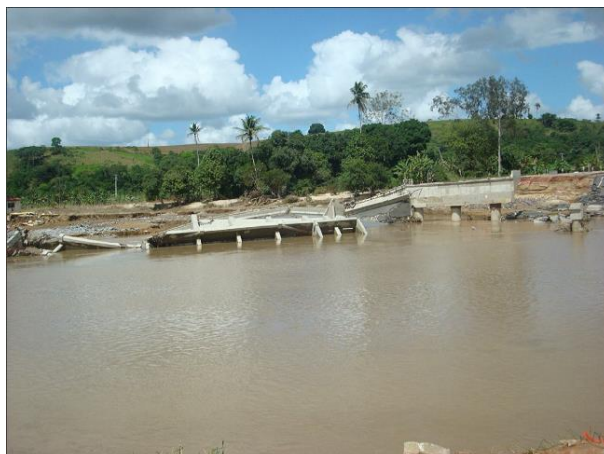
Figura 2.4 - Ruínas das duas pontes, que desabaram uma sobre a outra logo após o acidente causado pela cheia. (Fonte: acervo do autor)
