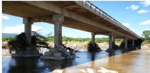
Figura 2.6 - Retenção e permanência de detritos nos pilares de uma ponte após uma cheia. (Fonte: acervo do autor)
