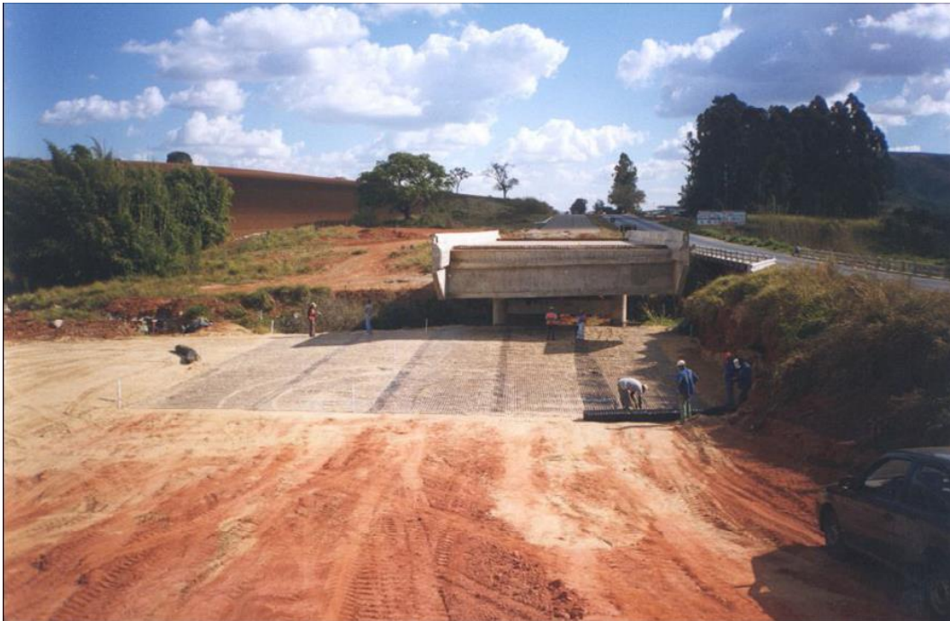
Figura 4.24 - Aplicação de geogrelha para reforço de solo no aterro de acesso de uma ponte. (Fonte: MACCAFERRI).
