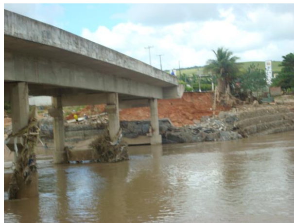
Figura 4.12 - Destruição dos aterros de acesso e retenção de material sólido pelos pilares da ponte. (Fonte: acervo do autor)
