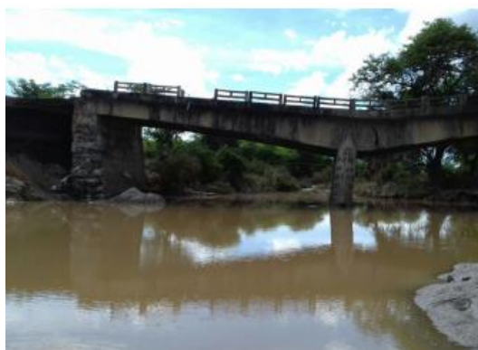
Figura 3.17 - Vista lateral da ponte mostrando a rotação do apoio central, o solapamento do encontro e as rótulas plásticas geradas pelos deslocamentos. (Fonte: acervo do autor)
