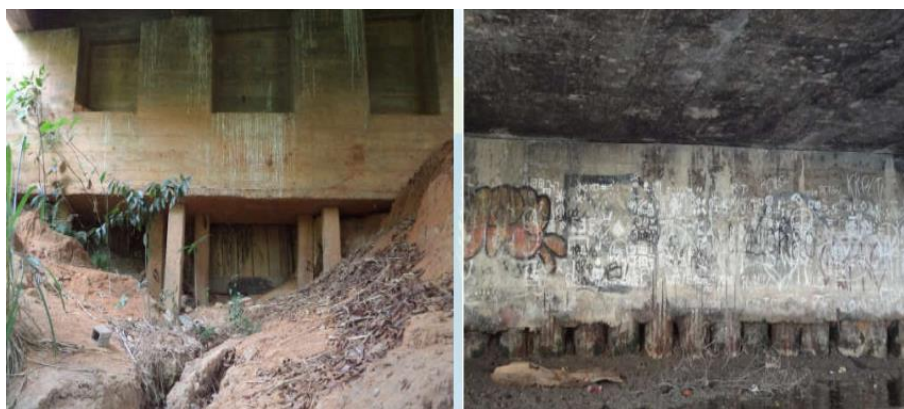
Figura 3.7 - a) Estacas de um encontro de ponte com grande perda de confinamento causado por uma erosão severa. b) Estacas de um encontro em um processo moderado de erosão, mas que continua evoluindo. (Fonte: acervo do autor)
