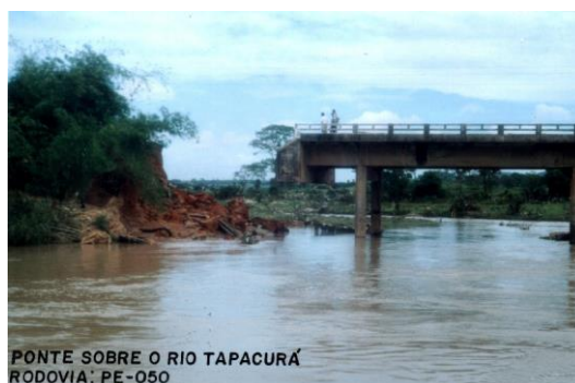
Figura 4.11 - Destrução total do aterro de acesso executado dentro da calha do rio. (Fonte: acervo do autor)
