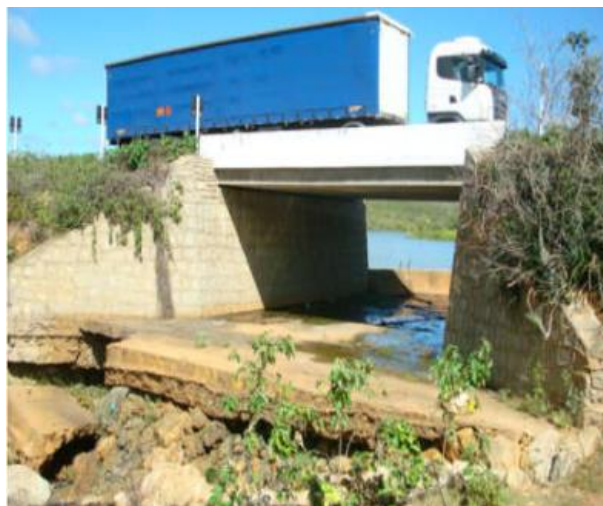
Figura 1.10 - Ponte locada sobre o aterro de um açude, numa condição de alto risco de erosão. (Fonte: acervo do autor)
