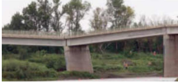
Figura 1.5 - Exemplo de deslocamentos causados pela erosão em tabuleiros com vigas isostáticas. (Fonte: Tech. Report, COST TU1406, 2018)
