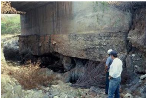
Figura 3.3 - Grande erosão na fundação de um encontro. (Fonte: acervo do autor)
