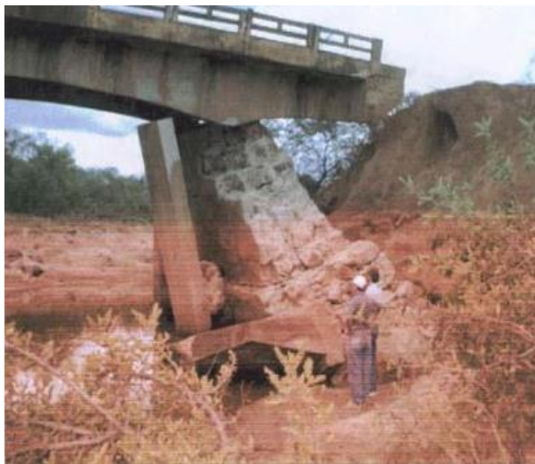
Figura 3.10 - Colapso causado pelo tombamento de um muro de contenção sobre os pilares da ponte. (Fonte: acervo do autor)
