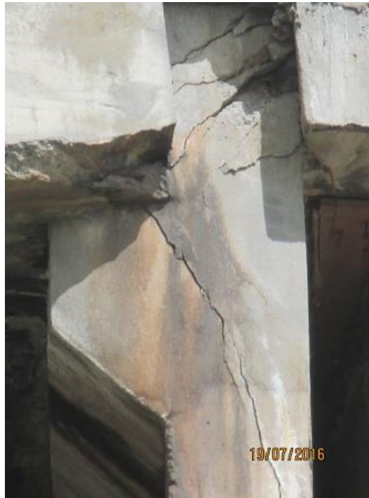
Figura 4.22 - Graves danos causados na cortina e no console pela rotação da laje de transição. ( Fonte: acervo do autor)
