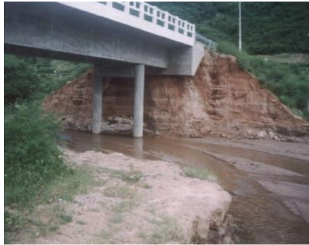
Figura 1.8 - Erosão causada pela locação da ponte em trecho curvo do rio. Observar a erosão na margem do raio externo e a sedimentação no lado do raio interno. (Fonte: acervo do autor)
