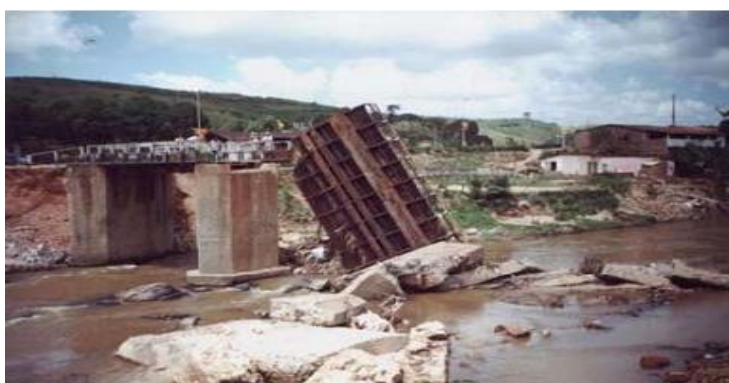
Figura 3.9 - Colapso total da ponte após uma cheia. (Fonte: acervo do autor)
