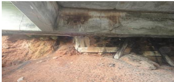
Figura 4.17 - Fuga do material do talude sob as cortinas, nas extremidades dos balanços, cujas alturas são insuficientes, desestabilizando o aterro de acesso e o pavimento. (Fonte: acervo do autor)
