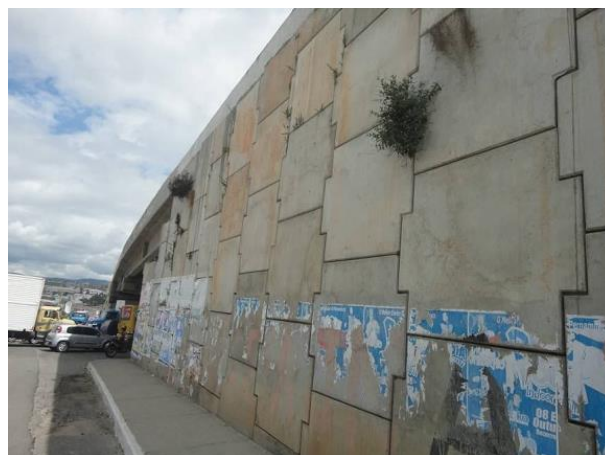
Figura 4.7 - Grande extensão de uma contenção de aterro de um viaduto urbano com terra armada, gerando a sensação de confinamento aos moradores das vias marginais. Observa-se também o surgimento de vegetação e outras patologias decorrentes de infiltrações e de falhas na fixação das escamas de concreto. (Fonte: acervo do autor)
