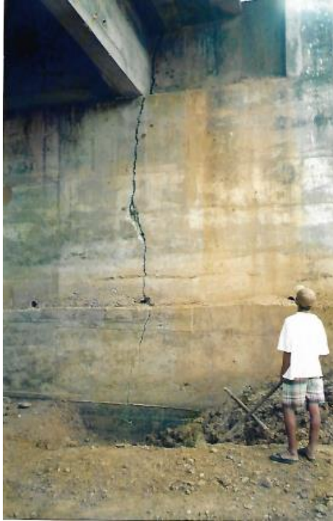
Figura 1.17 - Seccionamento da parede de um encontro de concreto ciclópico, causado pela erosão localizada e pela falta de resistência à tração do material. (Fonte: acervo do autor)
