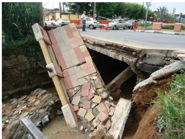
Figura 3.13 - Aspecto da ponte após solapamento dos encontros e desabamento de trecho do tabuleiro. (Fonte: ESTADÃO, 2012)
