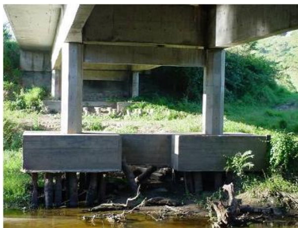
Figura 2.11 - Grave risco estrutural pela falta de confinamento das estacas causado pela erosão ampliada pelo desvio do leito original do rio ao longo do tempo. (Fonte: acervo do autor)
