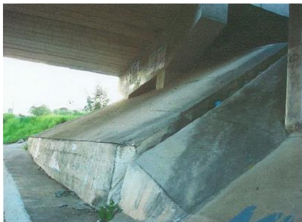
Figura 4.2 - Proteção do talude do aterro de acesso de ponte com extremidades em balanço com uma camada de concreto e um dissipador de energia para a descida das águas. (Fonte: acervo do autor)
