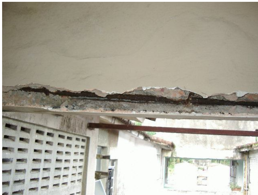
Foto 05 – Viga com armaduras em estado avançado de oxidação, na estrutura da torre de escada.
