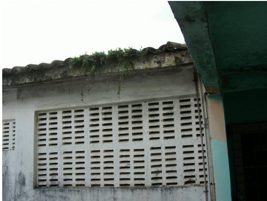
Foto 04 – Detalhe da má conservação do telhamento, inclusive com a presença de vegetação na coberta.
