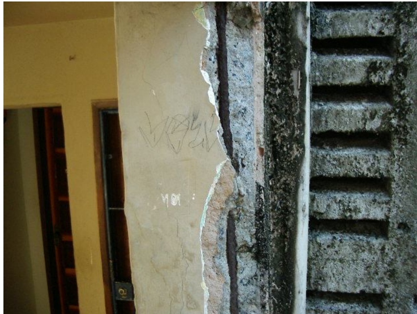
Foto 06 – Pilar com armadura em estado avançado de oxidação, na torre de escada e reservatório superior, caracterizando uma situação de risco estrutural.
