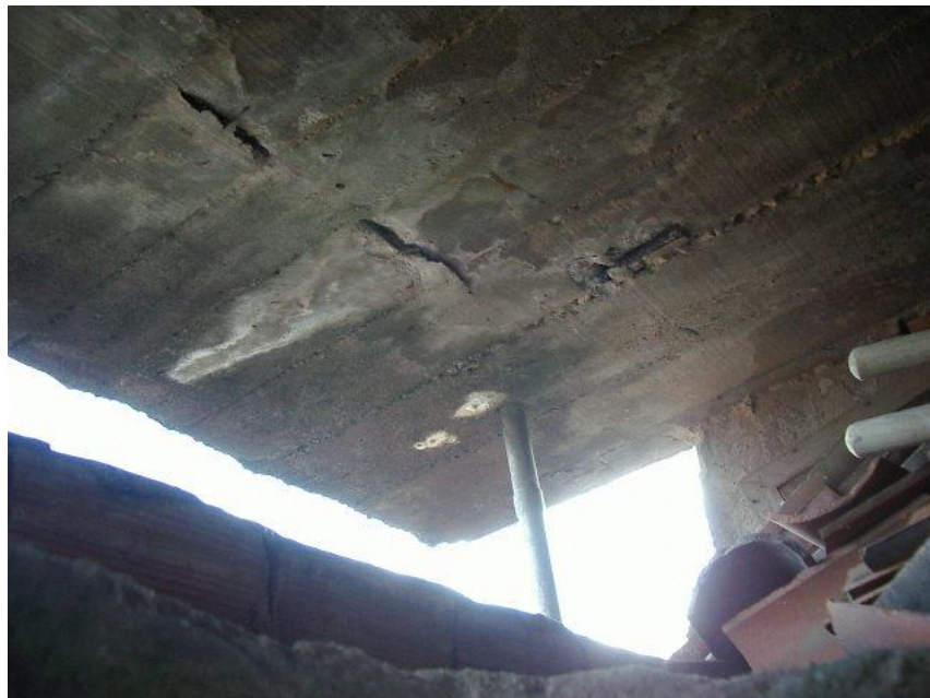
Foto 03 – Oxidação da armadura da laje de fundo de um dos reservatórios superiores, com deterioração do concreto e formação de eflorescências.
