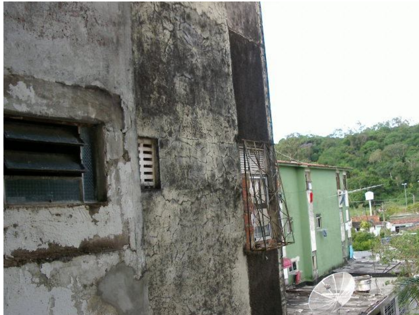
Foto 01 – Detalhe da falta de conservação das fachadas, totalmente degradadas pela infiltração que também atinge os tijolos, causando a diminuição da resistência das paredes.
