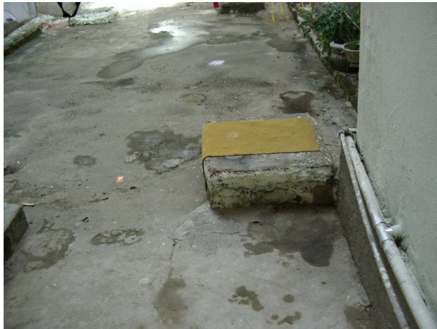
Foto 02 – Detalhe dos pátios internos com as redes de água, esgoto e drenagem próximas às paredes, causando infiltrações nas fundações.
