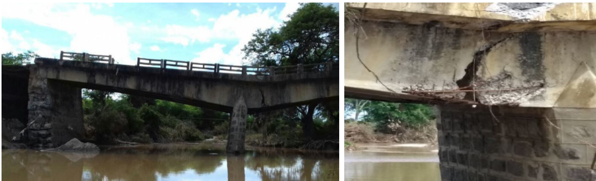
Figura 9 – Perfil da ponte e detalhe da ruptura das longarinas após o acidente estrutural. (VITÓRIO, 2019).
