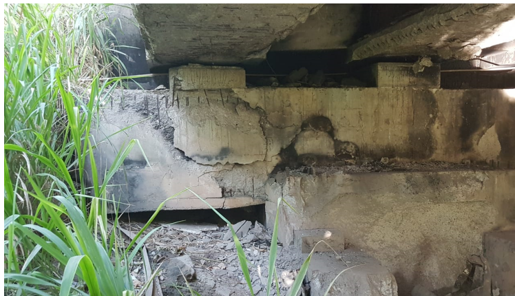
Figura 11 – Detalhe dos danos e deformação no balanço da travessa e nas extremidades das vigas do tabuleiro.
