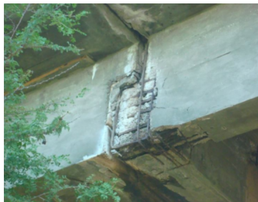
Figura 8 – Dente Gerber com grandes danos e risco de colapso do tabuleiro da ponte. (VITÓRIO, 2015)
