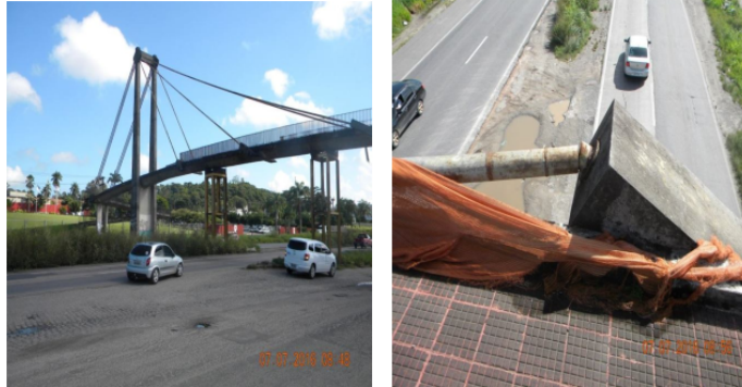
Figura 10 – Passarela escorada após a ruptura de um estai e o detalhe da ancoragem após o rompimento do cabo. (VITÓRIO, 2019).
