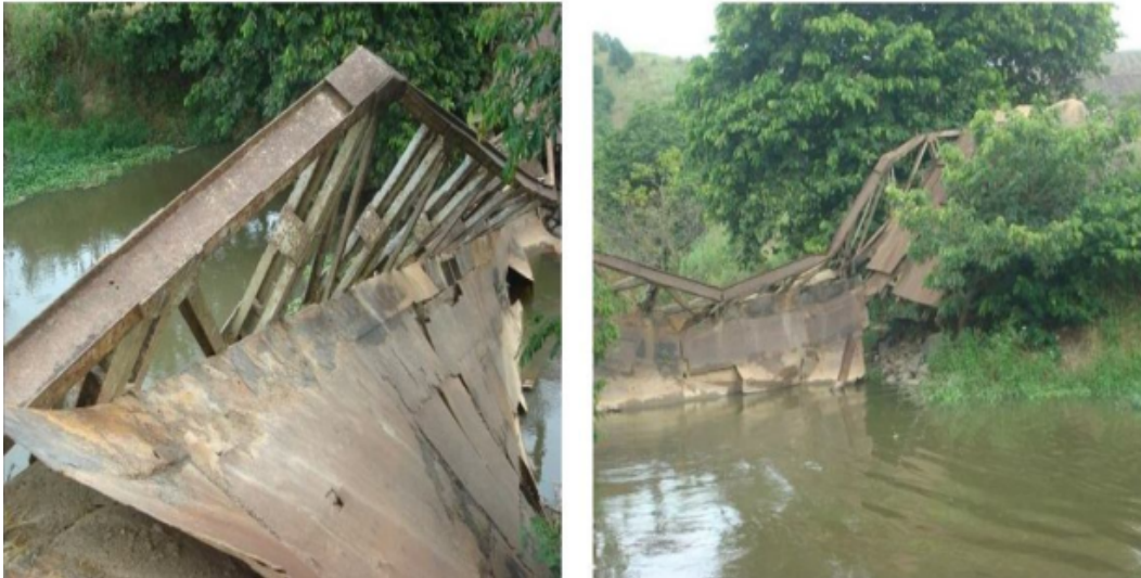
Figura 12 – Colapso progressivo nas treliças metálicas e ligações com acentuado grau de corrosão após o colapso da ponte. (VITÓRIO, 2019).
