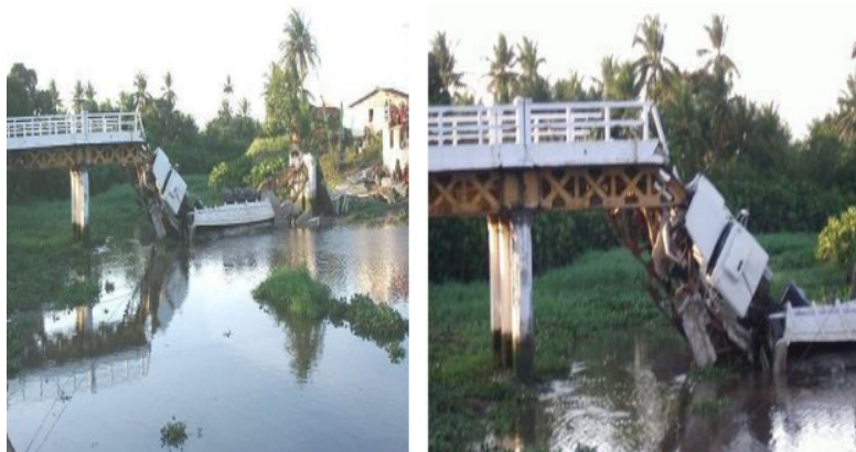
Figura 13 – Colapso dos tramos metálicos treliçados durante a passagem de um caminhão. (VITÓRIO, 2019).
