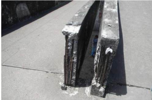
Figura 5 – Extremidades das vigas da passarela apresentando armaduras totalmente expostas e oxidadas
