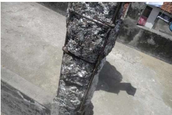
Figura 15 – Trecho de pilar apresentando condição de ruptura pela perda de seção transversal, degradação do concreto e destruição das armaduras.
