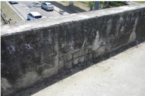
Figura 7 – Vigas invertidas funcionando como guarda-corpos, porém com insuficiência de altura e forte presença de corrosão de armaduras na mureta de proteção
