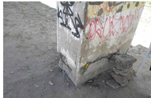
Figura 10 – Deslocamento do concreto na face inferior do pilar, situação típica da expansão das armaduras durante o processo de corrosão.
