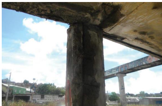
Figura 16 – Apoio do tabuleiro sobre o pilar mostrando acentuados danos no concreto e destruição de armaduras.
