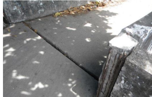
Figura 6 – Ausência de junta de dilatação na laje de piso (ligação da rampa com o patamar), possibilitando o acesso indesejado de infiltrações de água no tabuleiro
