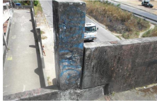
Figura 12 – Dente Gerber com abertura excessiva com indícios de rotação da viga no apoio.
