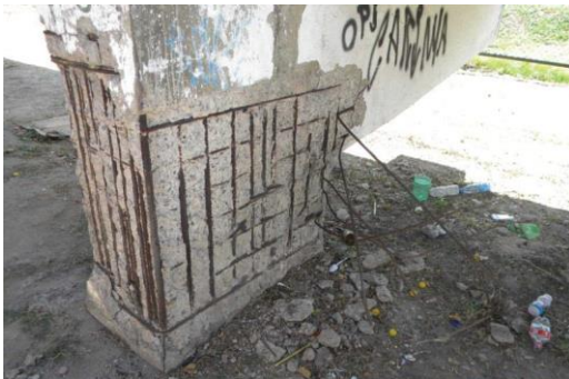
Figura 9 – Degradação do concreto com grande exposição e corrosão de armaduras. Observam-se perdas de seção e ruptura das armaduras verticais e dos estribos em um trecho do pilar.
