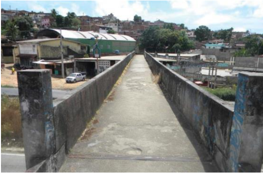
Figura 11 – Seção transversal da passarela com as vigas invertidas funcionando como guarda-corpo. Observar a intensidade da deterioração do tabuleiro.
