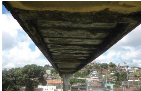
Figura 14 – Manchas e eflorescências de grande intensidade na face inferior do tabuleiro, decorrentes da deficiência do sistema de drenagem e da porosidade do concreto.
