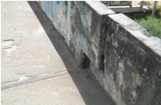
Figura 13 – Detalhe da região do dente Gerber destacando deslocamentos lateral, longitudinal e possível rotação no apoio da viga do tabuleiro.
