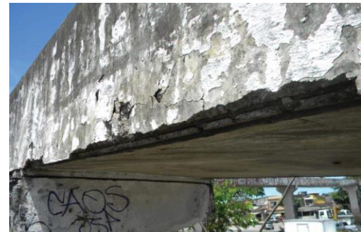
Figura 8 – Degradação do concreto e exposição de armaduras na face inferior das vigas do tabuleiro
